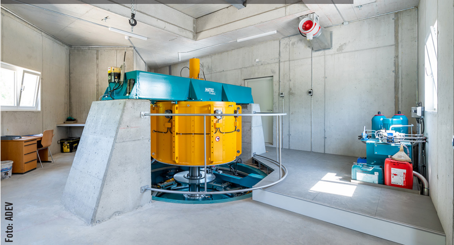
Watec-Hydro lieferte für das Kraftwerk Moosbrunnen 3 eine doppelregulierte Kaplan-Turbine mit direkt gekoppeltem Permanentmagnet-Generator. Im Regeljahr deckt die Anlage mit einem Erzeugnis von ca. 1,6 GWh den Strombedarf von rund 360 Haushalten.
