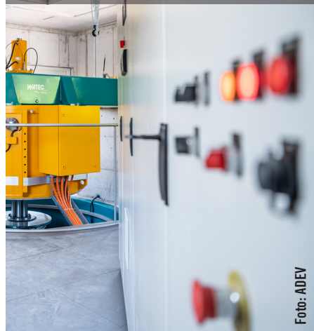
Die Kobel Elektrotechnik AG lieferte das komplette elektro- und leittechnische Equipment für das Kraftwerk Moosbrunnen 3, die Dotier-Turbine und den Stahlwasserbau am Emmenwehr.
